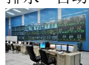
综合监控系统
