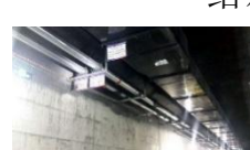
通风、空调与供暖系统
